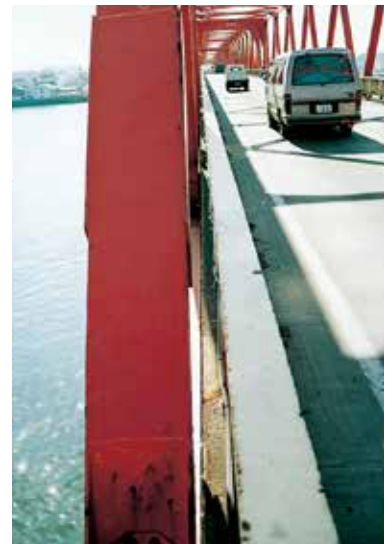
施工塗装後11年経過した 状態と非施工部分
