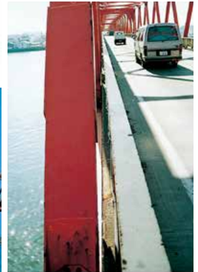
施工塗装後11年経過した状態と非施工部分
