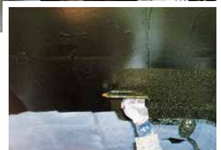
コンクリート橋の塩害防止
