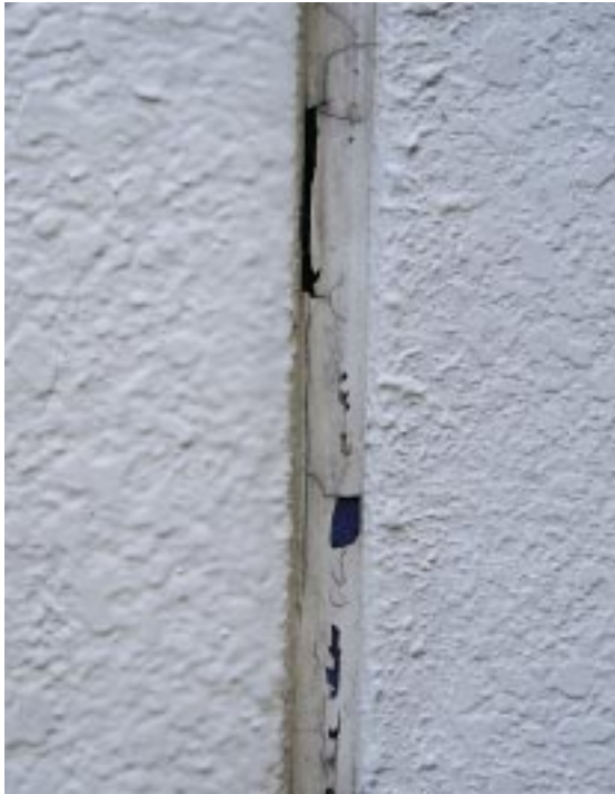
写真1 先打ちされたシーリング材上の塗膜のハガレ
