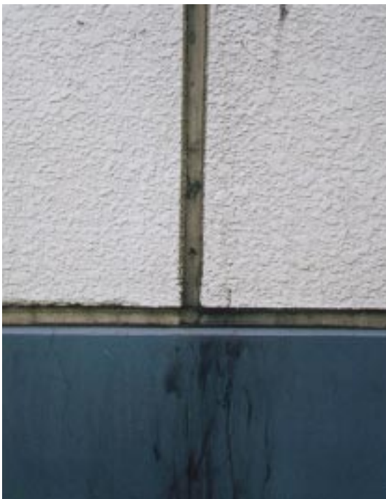
写真3 後打ちされたシーリング材からの集中した汚れ
