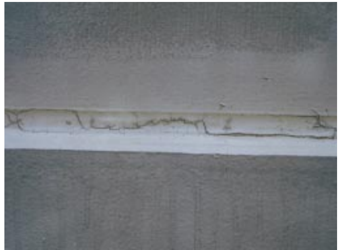
写真2 先打ちされたシーリング材上の塗膜のワレ
