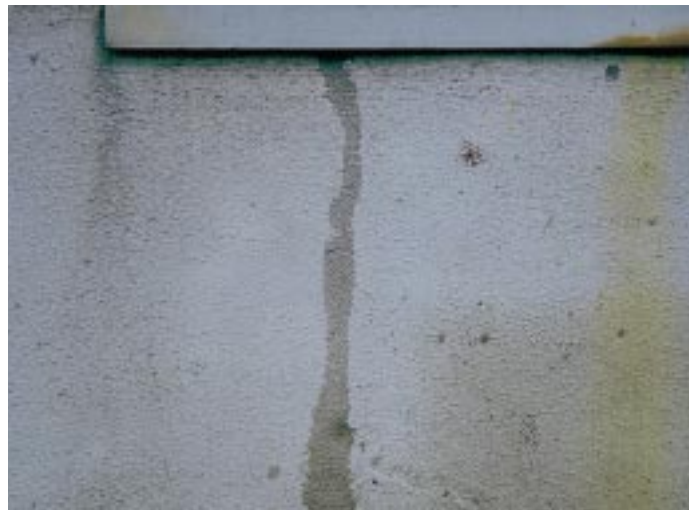
写真4 クラック補修で使われたシーリング材からの汚れ
