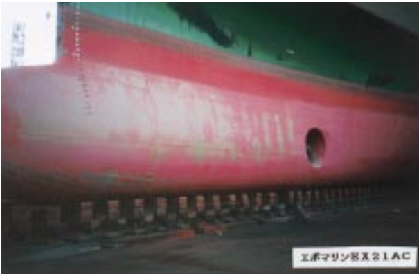
写真4 エポマリンEX21AC塗装船2年航行後の状態
