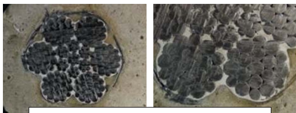
写真は塗装後のハンガーロープを切断した断面である。ハンガーロープの周囲の白い部分が塗膜であり、塗料がロープ内部にまで浸透していることが分かる。
