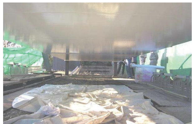
図19 下面塗装後の塗膜状態
